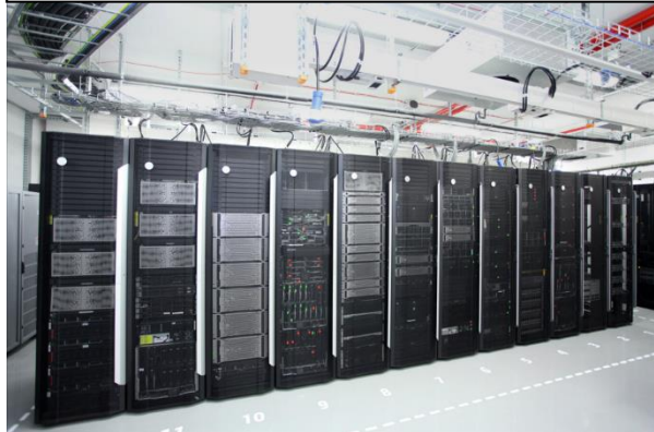
Centre de traitement de données à Sofia, en Bulgarie.
