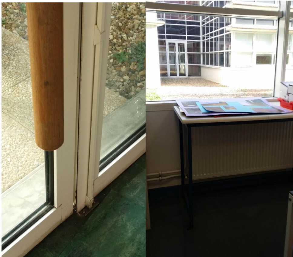
Porte de sortie pour se rendre à la cantine - elle ferme mal. Un radiateur encombré.
