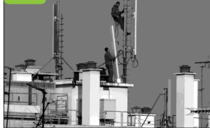
Doc.3 Installation d'une antenne relais sur le toit d'un immeuble.
